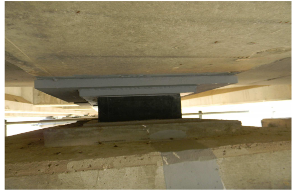
양방향 탄성받침 전경(P12 Sh5)
