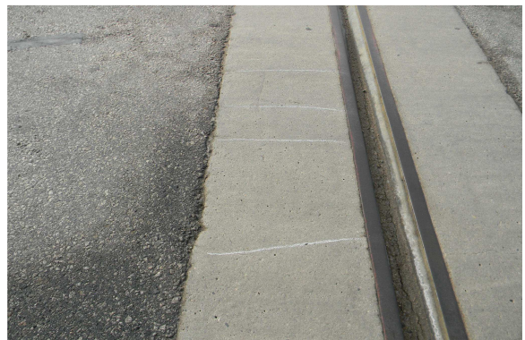
P3 후타재 균열
