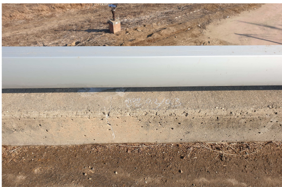
S1 연석 균열
