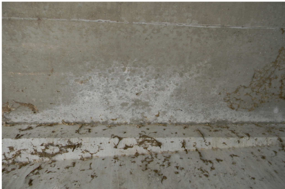
S16 바닥판하면 백태
