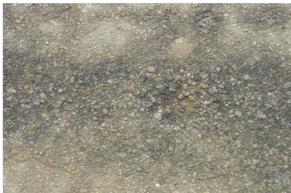
S18 교면포장 아스콘 패임
