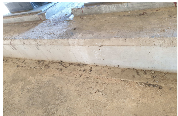
P5 Sh5 받침콘크리트 균열
