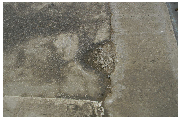
S19 교면포장 아스콘 파손
