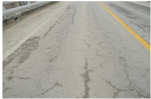
S15 교면포장 아스콘 망상균열
