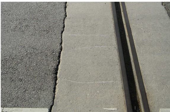
A1 후타재 균열
