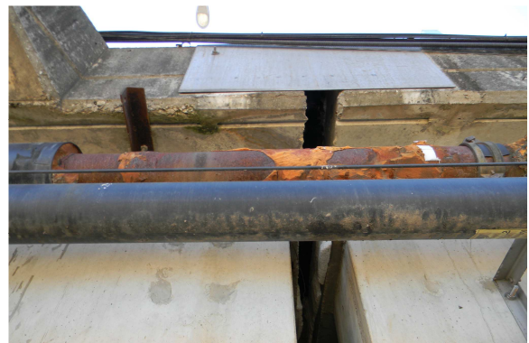
S7 배수관 고정부 파손
