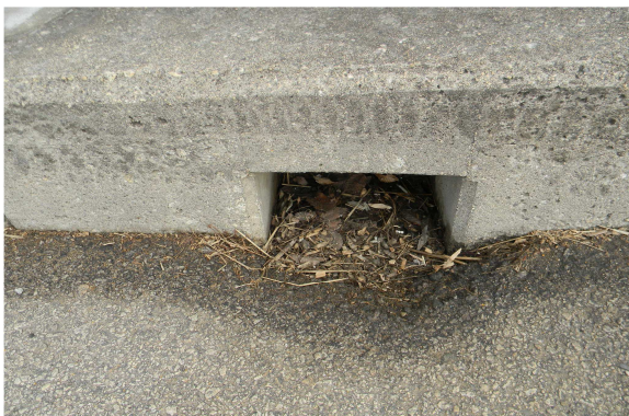
S6 교량상부 배수구 막힘
