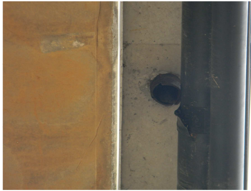
S8 배수관 탈락
