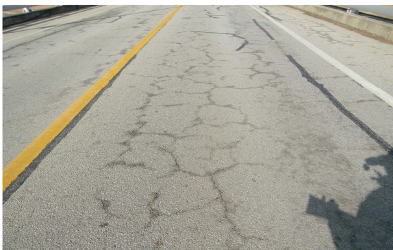
S2 교면포장 아스콘 망상균열
