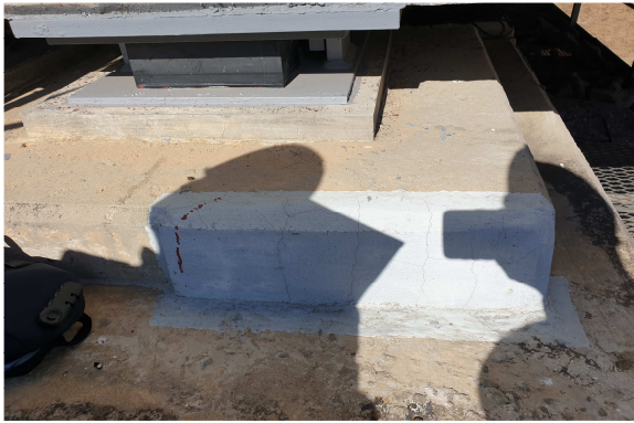
P8 Sh1 받침콘크리트 보수부 망상균열
