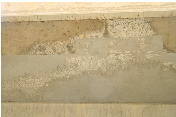
S2 바닥판하면 백태
