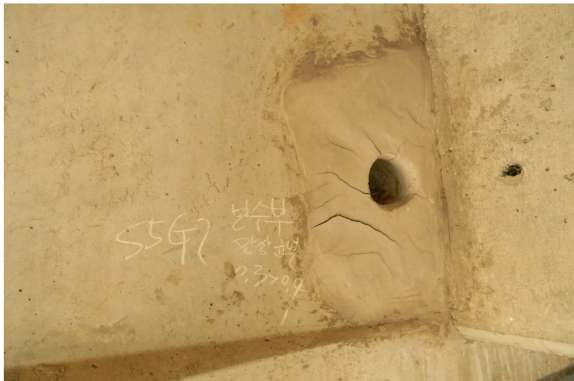
S5 G2 우측면 보수부 망상균열
