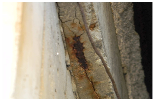
S6 바닥판하면 철근노출
