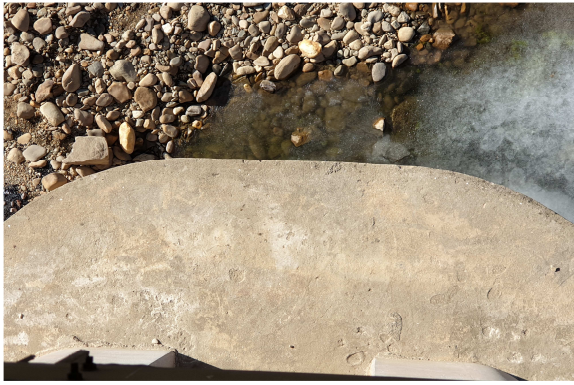
P11 기초 균열
