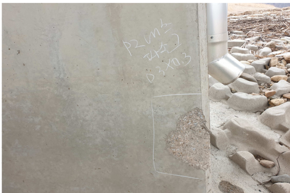
P2 기둥 파손
