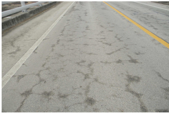
S10 교면포장 아스콘 망상균열
