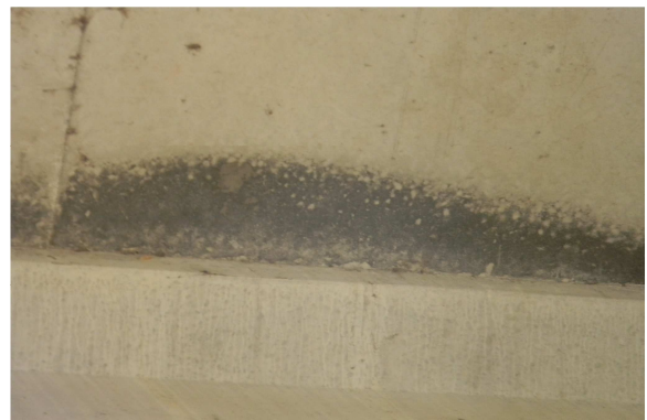
S3 바닥판하면 백태
