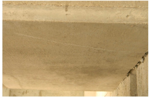
S4 G3~G4 가로보 하면 균열
