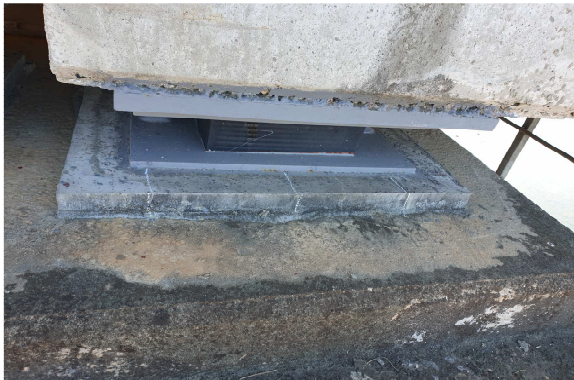
P11 Sh10 받침물탈 균열
