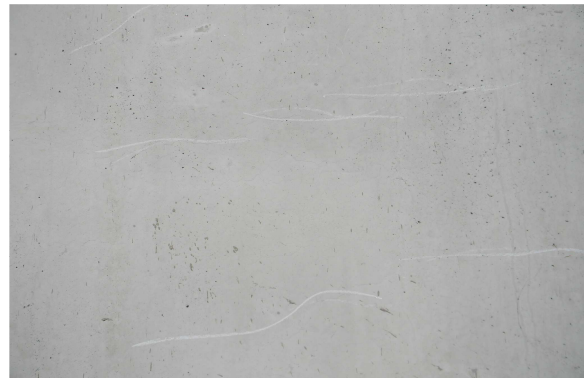
S10 G1 좌측면 균열
