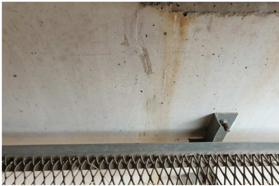
P19 코핑 균열
