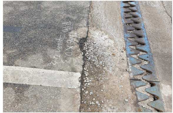
P18 후타재 파손
