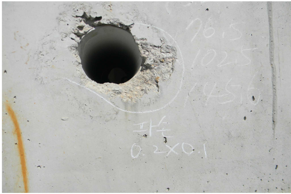
S1 G1 좌측면 파손
