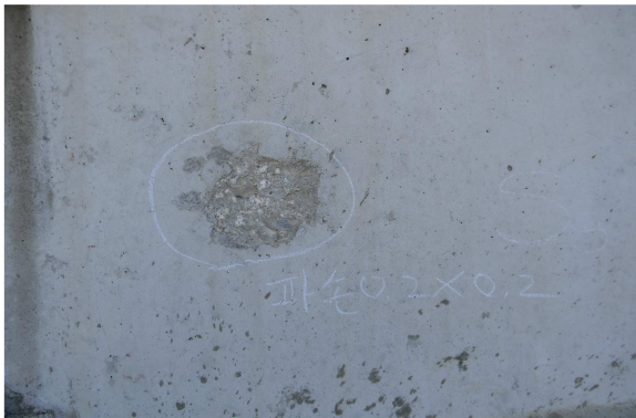
S8 G5 우측면 파손
